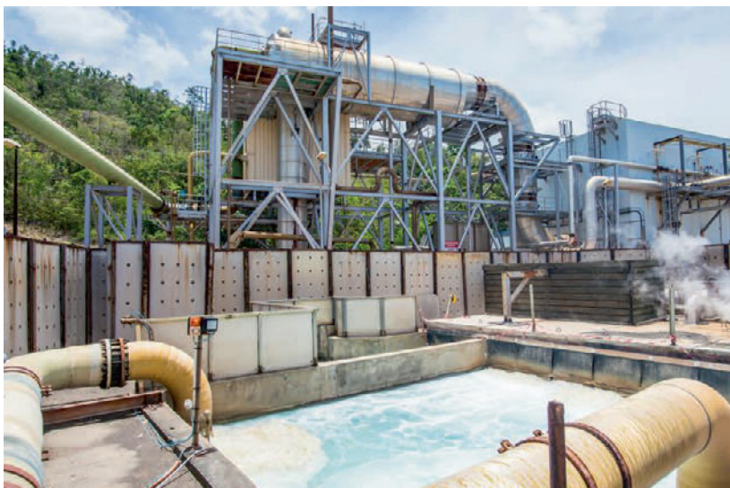
Centrale géothermique de Bouillante © Guillaume ARICIQUE
