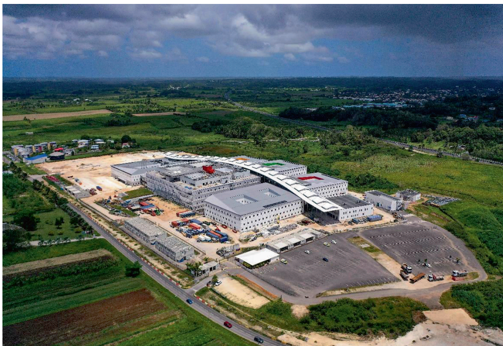
Chantier du nouveau CHU de la Guadeloupe situé à Belle-Plaine Abymes © CHU de Guadeloupe
