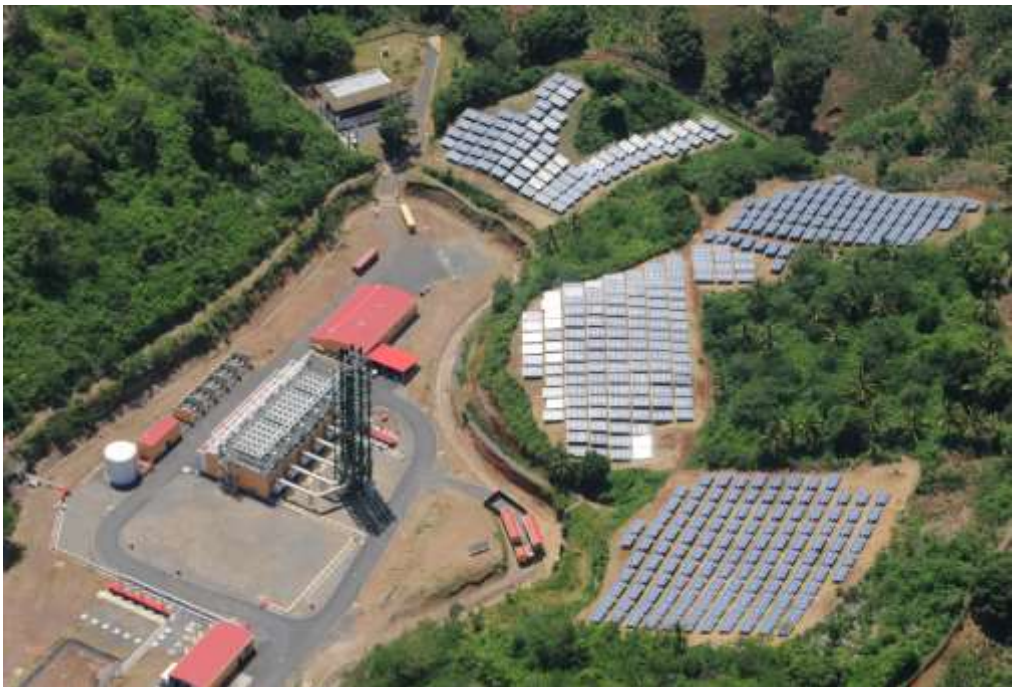
Champ de panneaux solaires à Longoni (Electricité de Mayotte - EDM)
